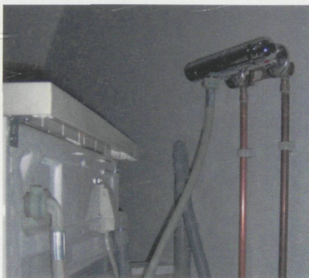
WASMACHINE AANGESLOTEN OP EEN THERMOSTAAT-KRAAN OM ZO TE PROFITEREN VAN HET WARME WATER VAN DE ZONNEBOILER.
